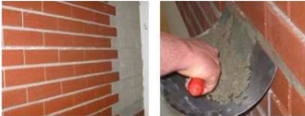
Figura 37. Detalle de la instalación de un acabado de aplacado imitando ladrillo cara vista.
