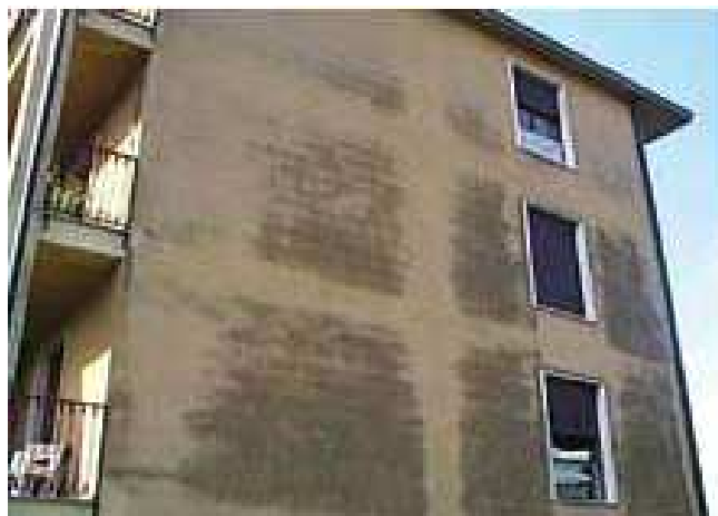
Figura 2. Edificio con defectos en los pilares y frentes de forjado
