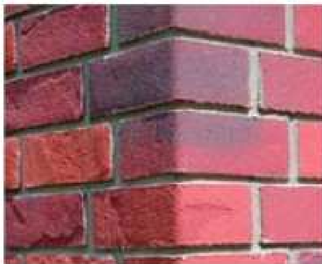
Figura 39. Detalle de esquina de la instalación de un acabado de ladrillo sobre un sistema SATE.
